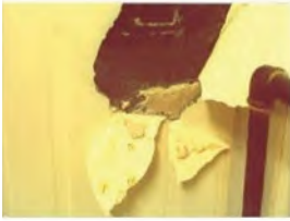
KOROZYON VE MİKROBİYOLOJİK SORUNLAR
